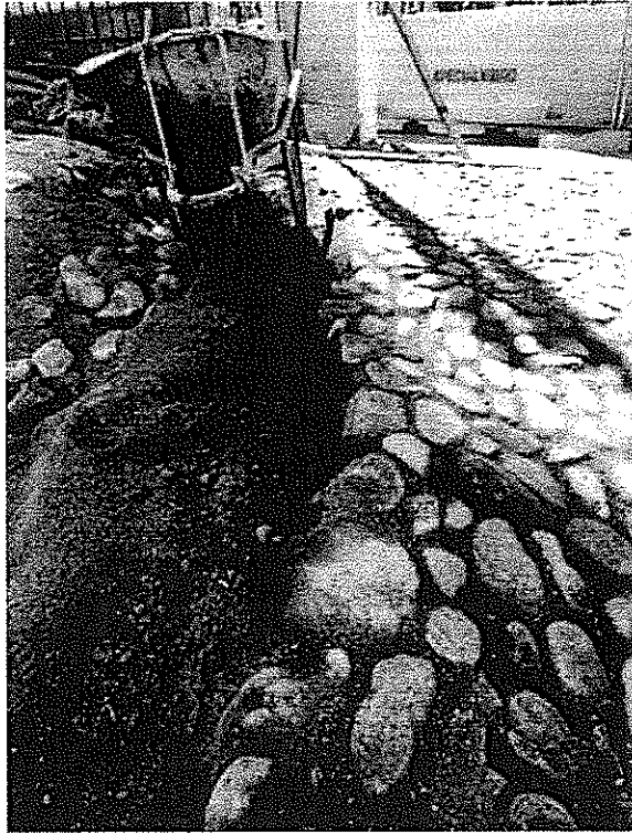
← Sezione di allettamento del manto di pavimentazione con pillole lapidee disposte "a coltello" con due terzi della lunghezza affogate nel fondo;
