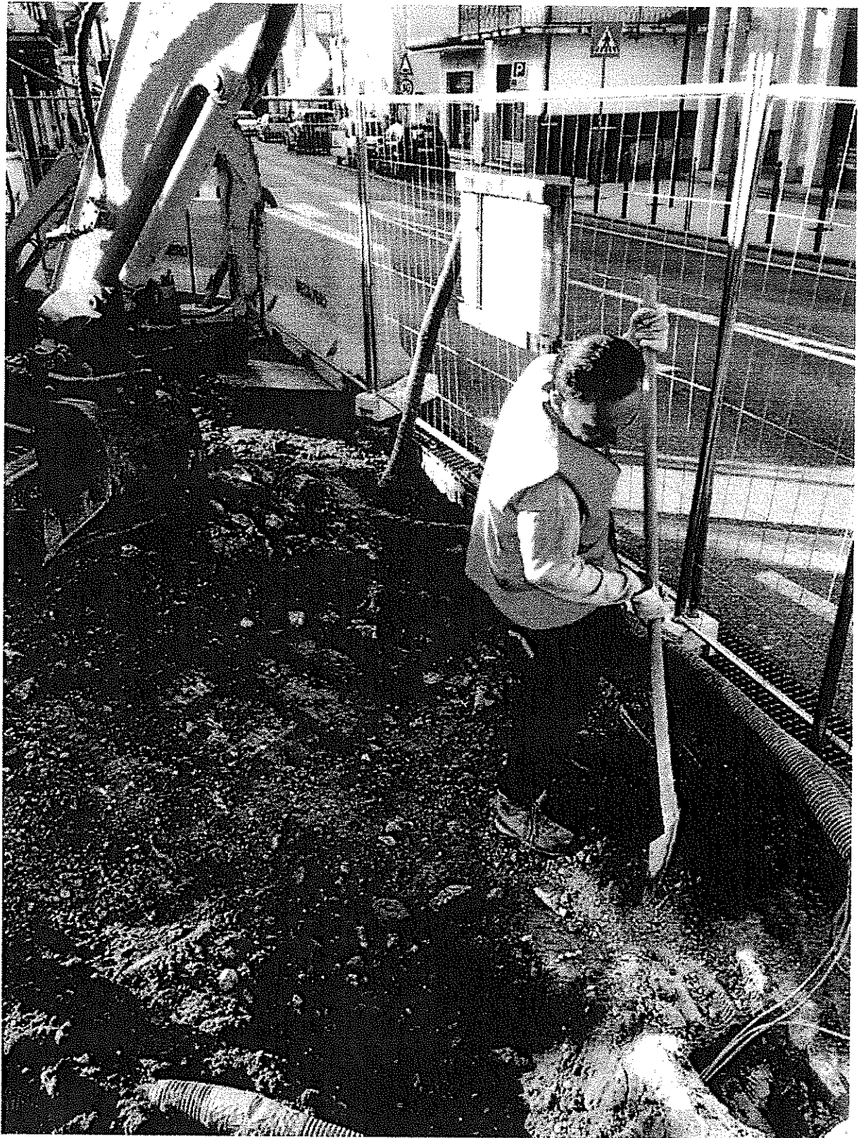
↑ Scavi e rinterri dei cavidotti rinvenuti al di sotto della pavimentazione stradale;
