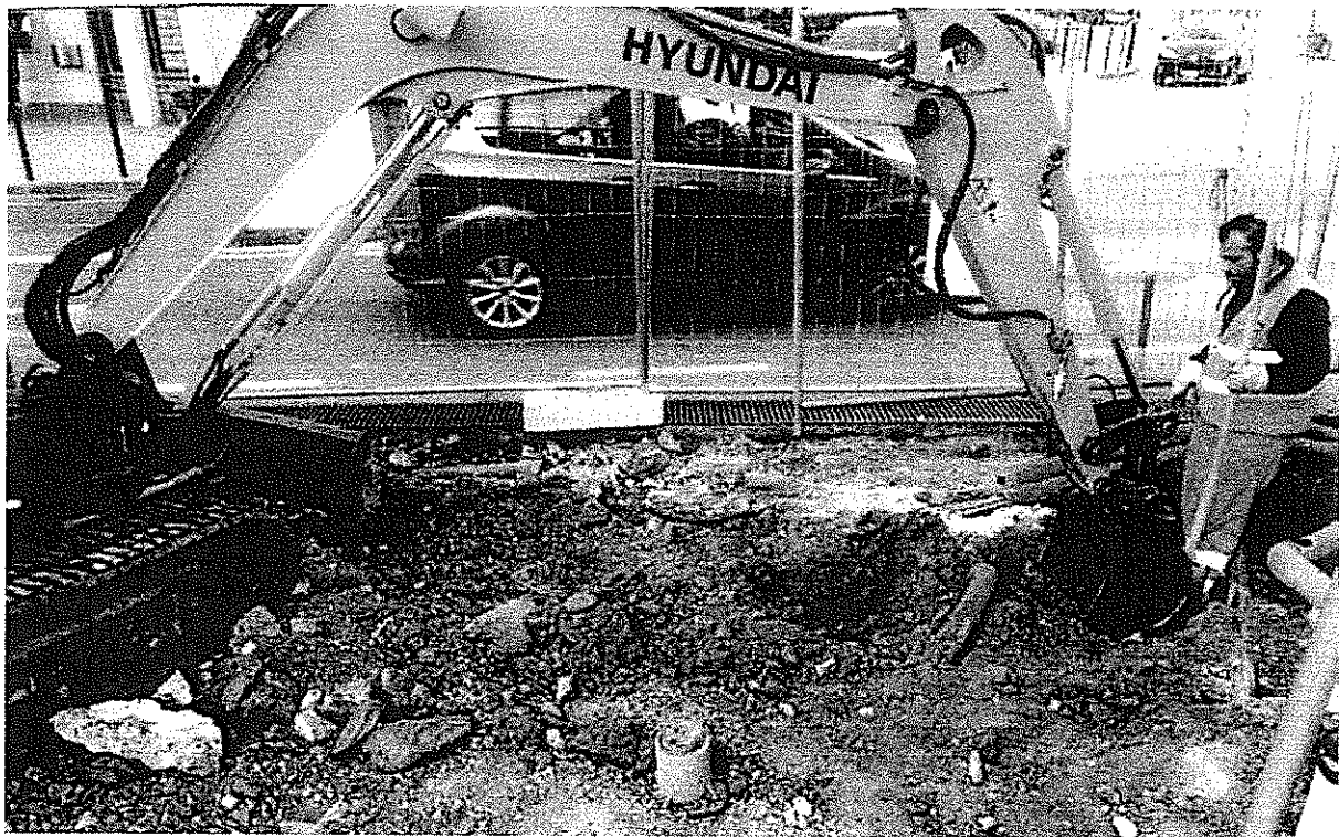
↑ Operazioni di scavo realizzate con pala meccanica per il re-integro dei cavitotti elettrici rinvenuti alla base dell'area di intervento a seguito dello smontaggio delle pillole lapidee di pavimentazione della strada;
