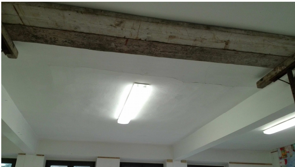
Vista della lesione nel terzo campo della copertura dell'atrio
