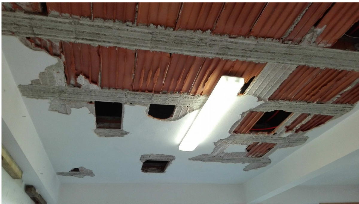
Rimozione delle porzioni pericolanti delle tavelle nel terzo campo di copertura dell'atrio
