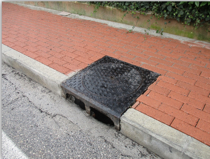
Bocca di Lupo disposte ogni 20 m per lo smaltimento delle acque meteoriche
